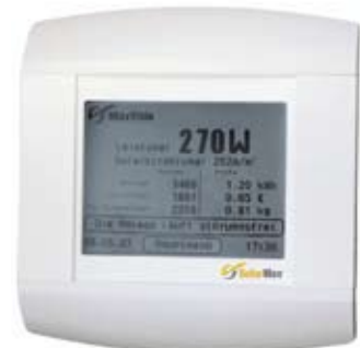
■ So kann ein Datenlogger für kleinere Photovoltaikanlagen ohne Fernüberwachung aussehen (im Bild zu sehen der MaxViso von Sputnik). Bild: Sputnik
